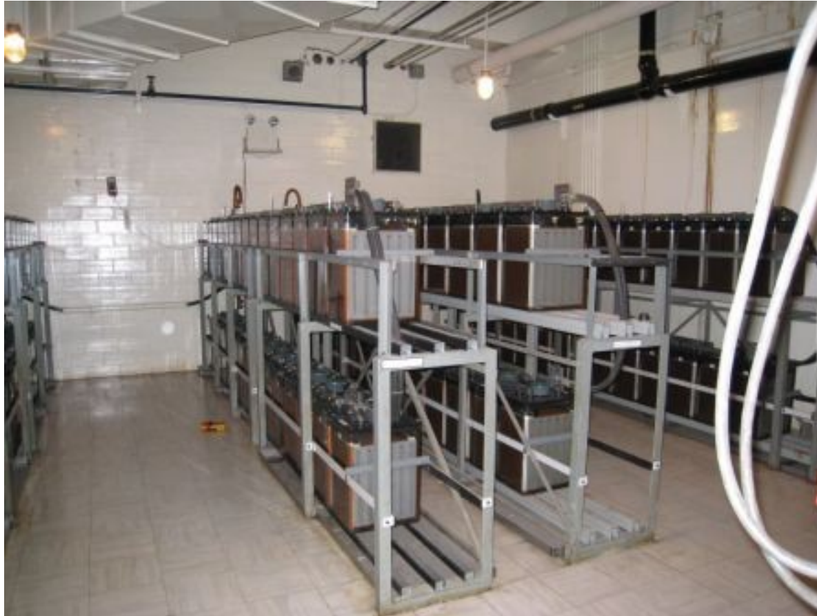
Bancs de batteries de catégorie I
