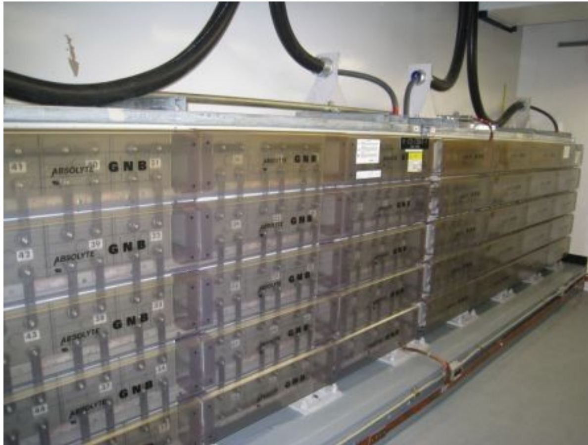
Bancs de batteries de catégorie I
