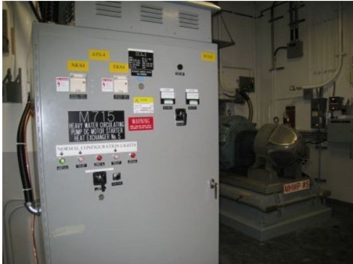
Dispositif de démarrage en courant continu pour la PPEL #5
